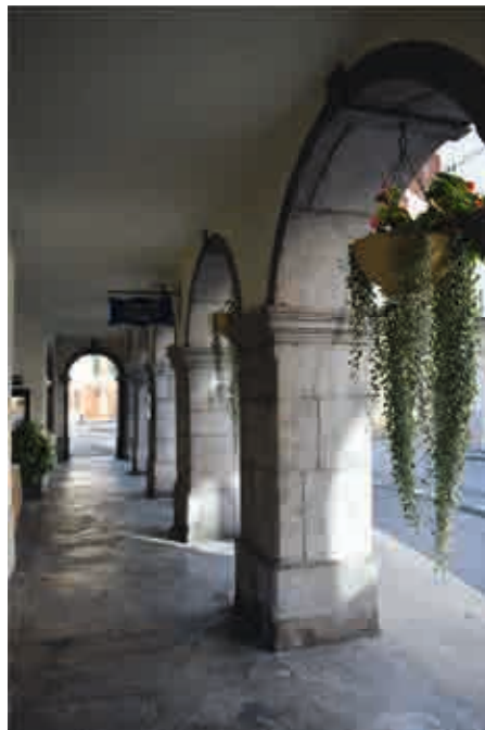
Abb.1: Arkaden beim Restaurant Hôtel de Ville in Bex; Bodenplatten, Pfeiler und Bogensteine in St-Triphon
